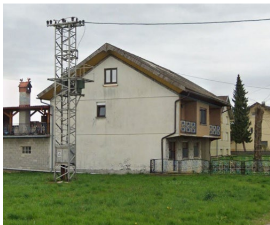
Slika 10. Trafostanica Hudi Bitek u Brezovičkoj ulici
